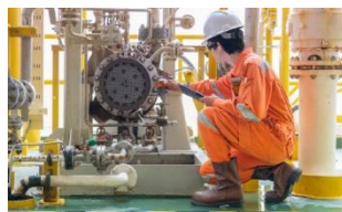
工場へ接続 確認/保守/教育
